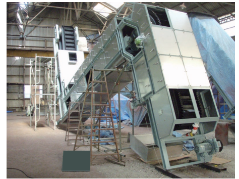
金町浄水場 フレックスコンベヤ (機長 21m)
