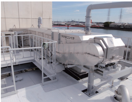
柴田処理場 計量コンベヤ (機長 34m)
