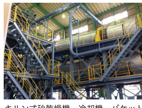
キルン式砂乾燥機、冷却機、バケット エレベーター等搬送機器及び集塵配管 (砂乾燥設備一式)
