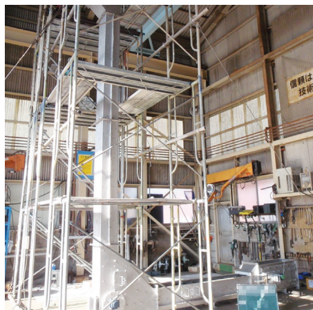
四国中央市クリーンセンター チェーンコンベヤ機長10m
